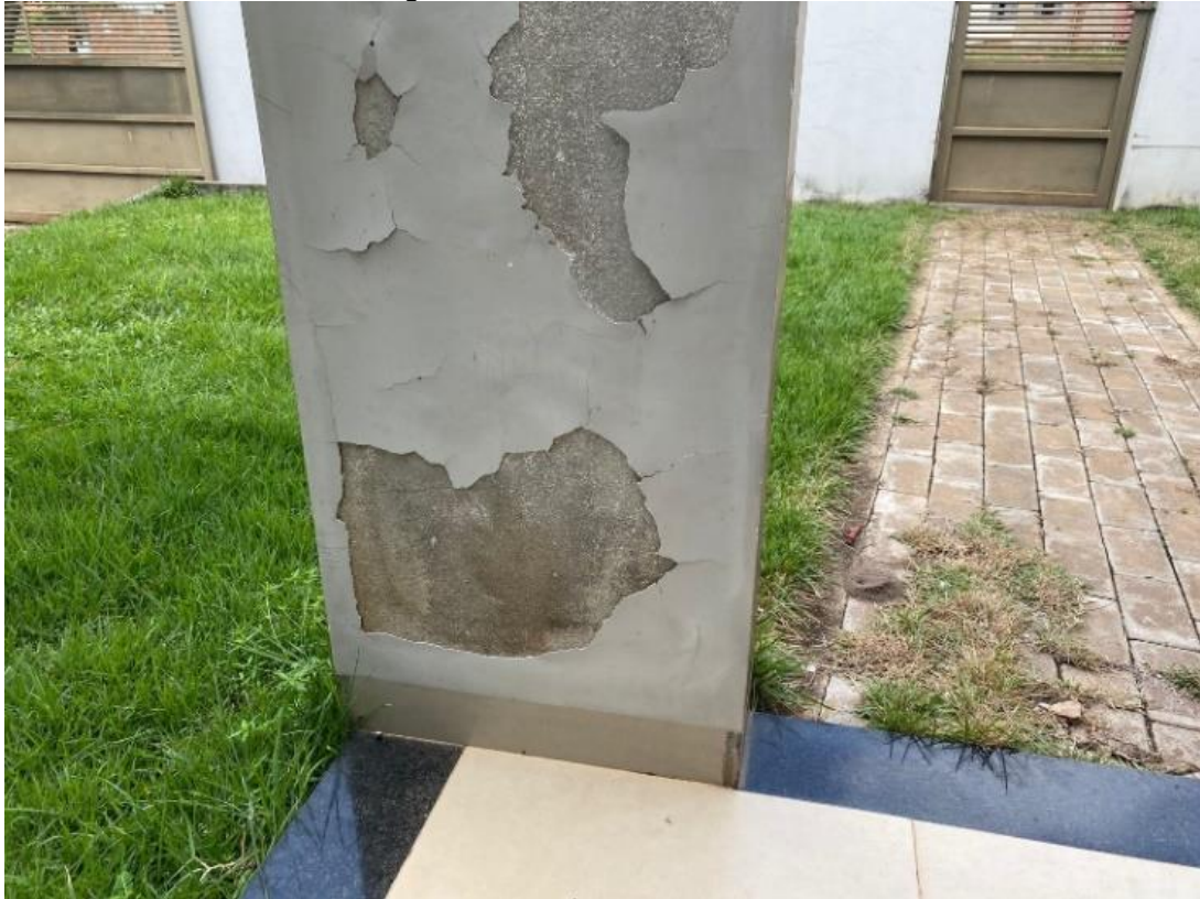
Figura 2- Descascamento de tinta.
