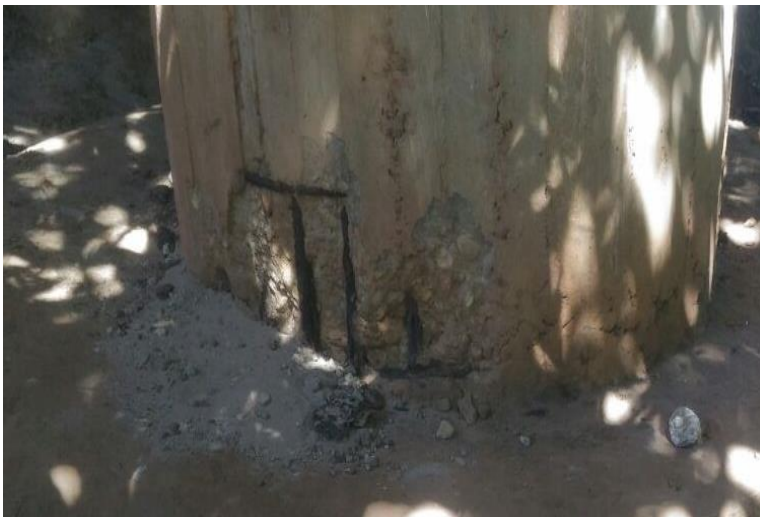
Figura 7 - Aparecimento da armadura em pilar, provocando corrosão da armadura de aço.
