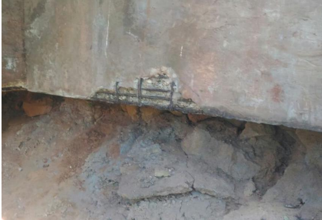
Figura 6 - Descolamento de concreto e armadura exposta com presença de corrosão
