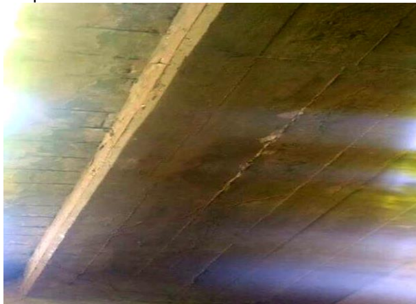
Figura 3 - Aparecimento de corrosão de armaduras.
