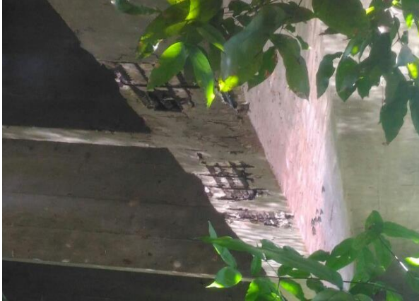
Figura 4 - Armaduras expostas e concreto deslocado e sem aderência
