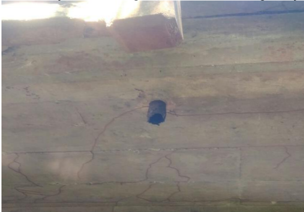
Figura 5 – Tubulação de drenagem em estado de degradação.
